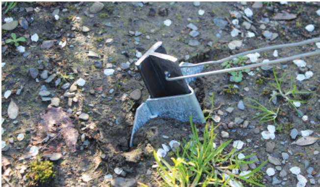
Ancrage renforcé grâce à la croix.
